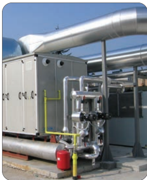
Ductos conectan el CC3-GL a la planta
