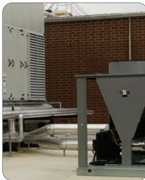
CC3-GL con conexión a enfriadores de agua
